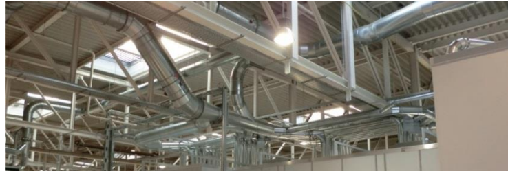
Sieć rurociągów transportująca pył do filtrów BETH
